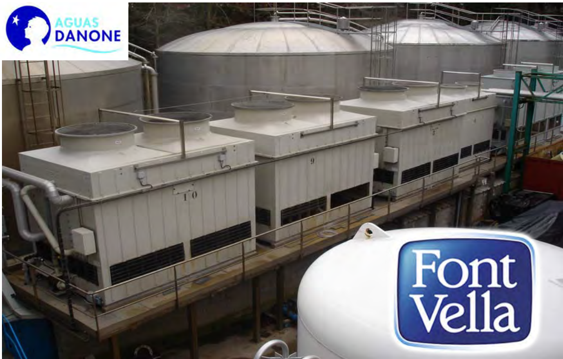
FONT-VELLA (GRUPO DANONE) Sant Hilari Sacalm (Girona) 4 torres de refrigeración Total: 3,5 MW
