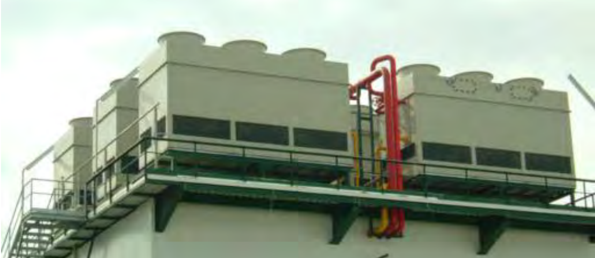
Mollerussa (Lleida) 6 condensadores evaporativos NH3 Total: 8,4 MW
